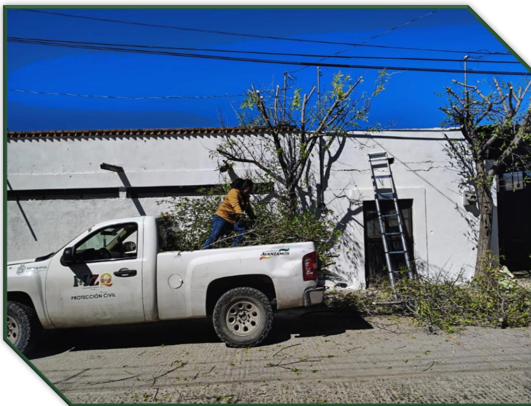
Poda preventiva de árbol que afectaba el cableado de luz
