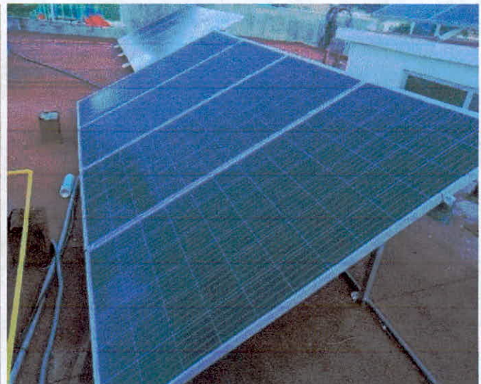
INSTALACIÓN DE SISTEMAS FOTOVOLTAICOS
