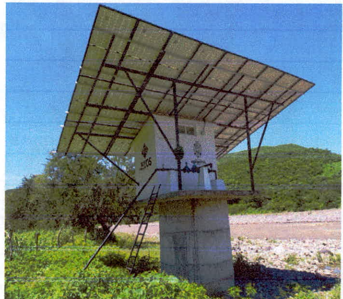
EQUIPO FOTOVOLTAICO, CASETA Y GALERIA FILTRANTE
