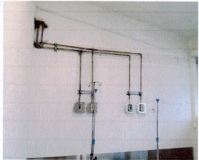
RED DE DISTRIBUCIÓN DE AIRE LIMPIO Y OXIGENO
