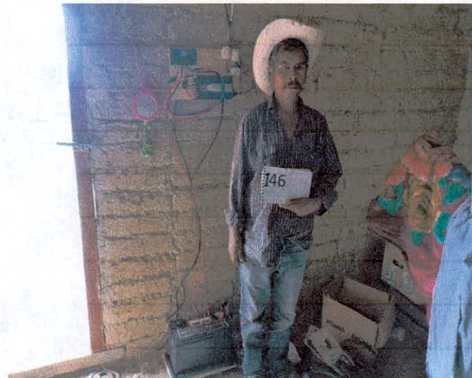
INSTALACIÓN DE SISTEMAS FOTOVOLTAICOS
