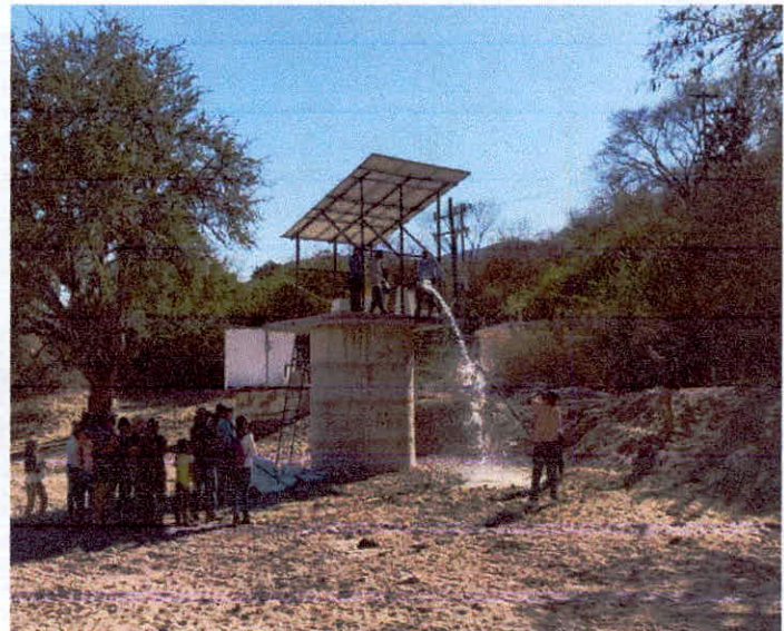
EQUIPO FOTOVOLTAICO, CASETA Y GALERIA FILTRANTE
